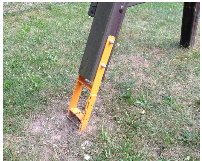
Provisorische Reparatur am Schaukelbein
