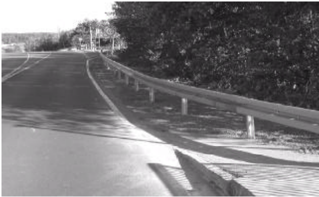
Späte Reaktion: als Sofortmaßnahme wurde die Schutzplanke am Ende der Brücke zurückgesetzt.
